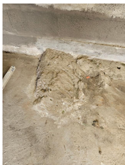
Fjellknaus mot bakvegg i garasje.
