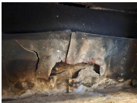
Skader på ovn i underetasje.
