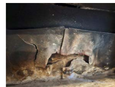
Skader på ovn i underetasje.
