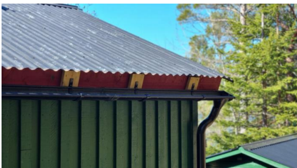
Takrenne fasade øst er montert med for stor avstand til taktekket.
