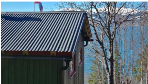
Det mangler vannbord på tak fasade nord.
