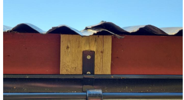
Begrenset overlapping på enkelte bølgeblikkplater.
