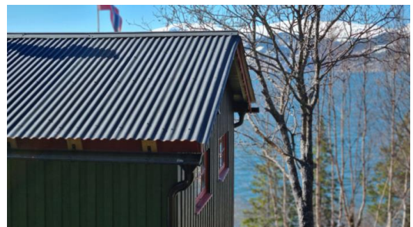
Manglende vannbord på fasade nord.
