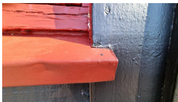
Utvendig omramminger på vinduer er montert helt ned til vannbordet, dette kan føre til vannoppsug/råte i omramming/dekkbord. Det er anbefalt med minimum 6 mm avstand fra nedkant av omramming til det nederste vannbrettet.
