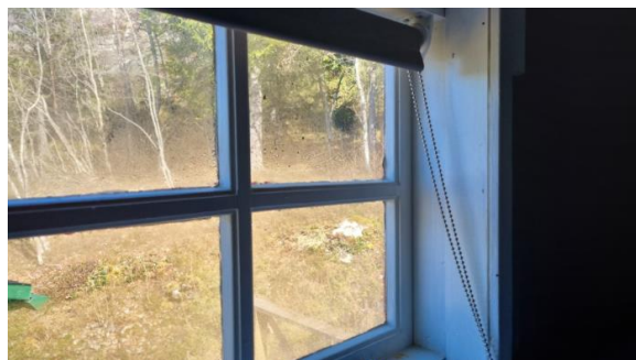
Kondensering mellom glass på det ene soverommet.
