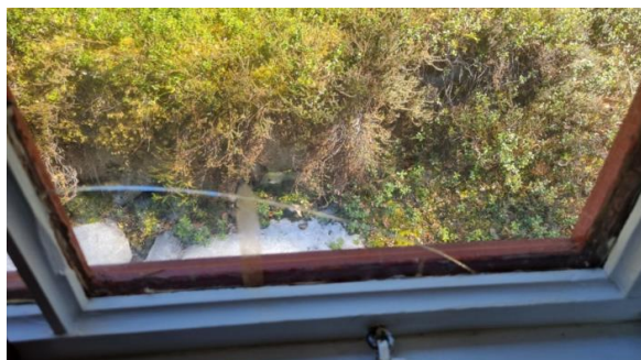
Sprekk i glass i stuevindu.
