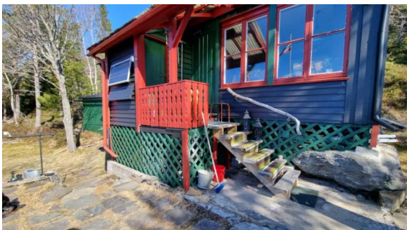
Trapp til inngangsparti mangler rekkverk.
