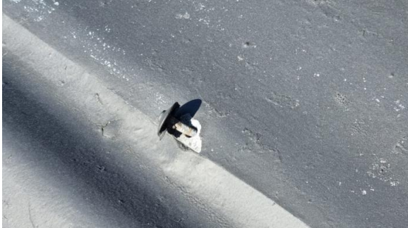
Enkelte løse spiker på bølgeblikkplatene.
