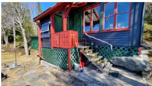
Trapp til inngangsparti mangler rekkverk.
