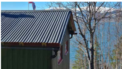
Det mangler vannbord på tak fasade nord.
