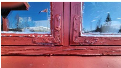
Enkelte vinduer er noe utvendig værslitt.
