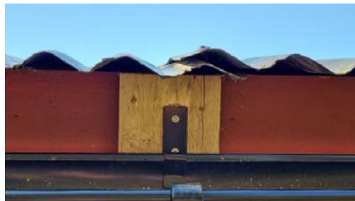
Begrenset overlapping på enkelte bølgeblekkplater.
