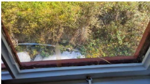
Sprekk i glass i stuevindu.
