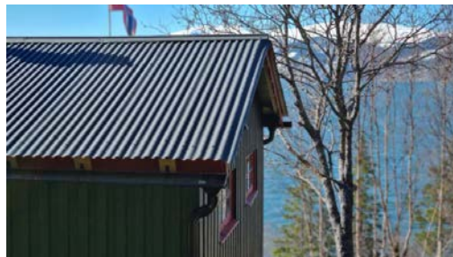
Manglende vannbord på fasade nord.
