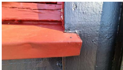
Utvendig omramminger på vinduer er montert helt ned til vannbordet, dette kan føre til vannoppsug/råte i omramming/dekkbord. Det er anbefalt med minimum 6 mm avstand fra nedkant av omramming til det nederste vannbrettet.
