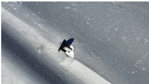
Enkelte løse spiker på bølgeblekkplatene.
