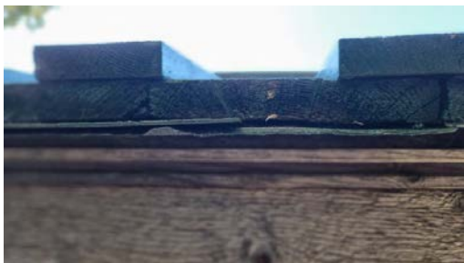
Ingen lufting i nedre kant av kledningen.
