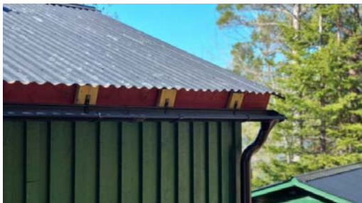
Takrenne fasade øst er montert med for stor avstand til taktekket.
