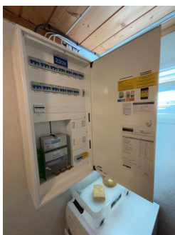
Sikringskap plassert i vaskerom i kjeller
