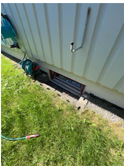
Lav høyde mellom terreng og kjellervinduer.
