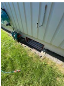
Lav høyde mellom terreng og kjellervinduer.
