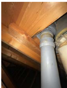
Synlige fuktmerker, men tørre på befaringstidspunktet.
