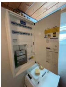
Sikringsskap plassert i vaskerom i kjeller
