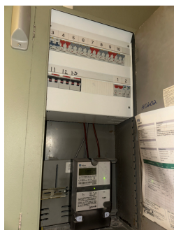
Sikringsskap med automatsikringer.
