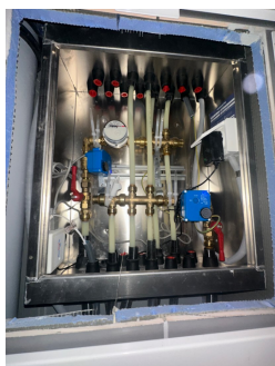
Samleskap med rørkurser og stoppekraner
