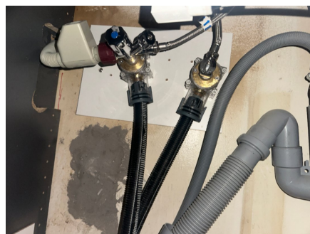
Røropplegg i kjøkkenbenk
