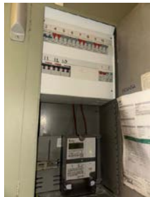
Sikringsskap med automatsikringer.
