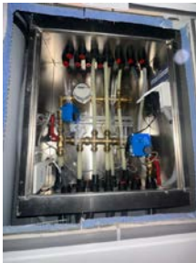
Samleskap med rørkurser og stoppekraner
