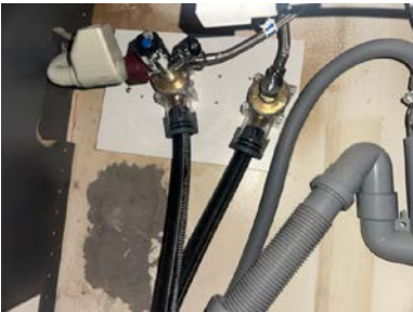
Rørapplegg i kjøkkenbenk
