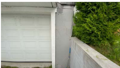
Noe synlig løs puss på grunnmuren ved garasjedør.
