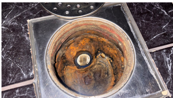
Eldre sluk av støpejern
