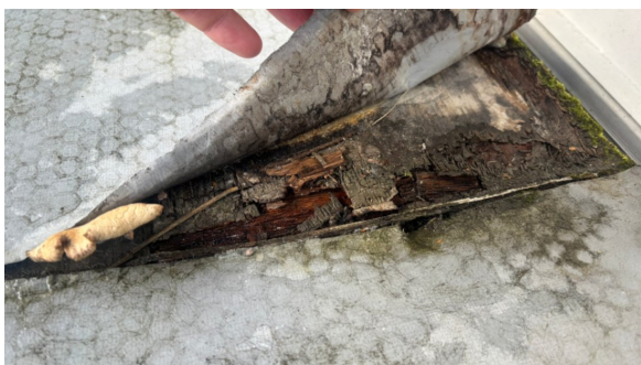
Råteskader på treverk under dekke
