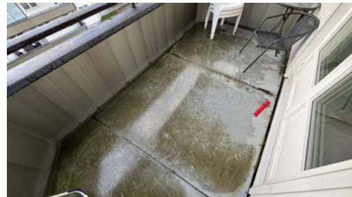
PVC-folien er svært slitt
