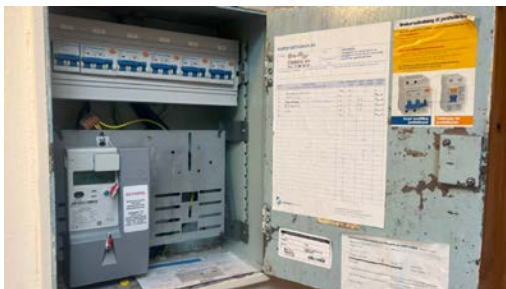
Sikringsskapet er plassert like utenfor leiligheten i fellesarealet
