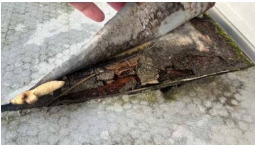
Råteskader på treverk under dekke
