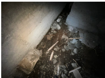
Fukt på deler av gulvet.
