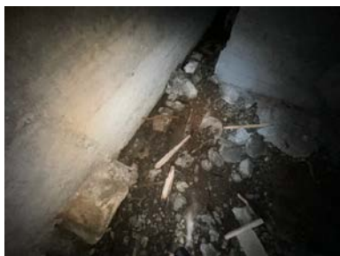
Fukt på deler av gulvet.
