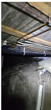
Kondensering på rør og lav høyde/begrenset tilgang.
