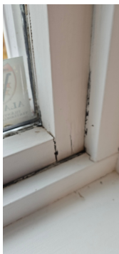
Svartsopp og kondens på innvendig vindus rammer.
