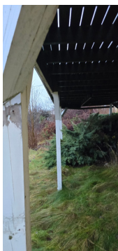
Fukt opp trekk fra terreng i stopler.
