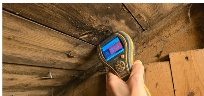
Høy fukt nivå på under tak
