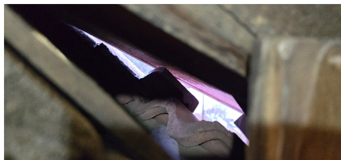
Synlig manglede beslag og utett mellom vegg og tak fra loft, vann inn driv.
