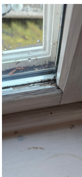
Svartsopp og kondens på innvendig vindus rammer.
