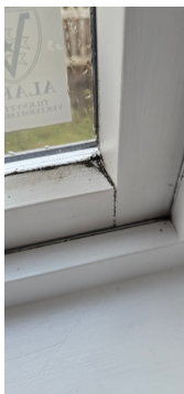
Svartsopp og kondens på innvendig vindus rammer.
