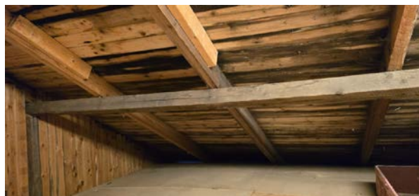
Synlig nedbygning i tak konstruksjon i bærebjelke.
