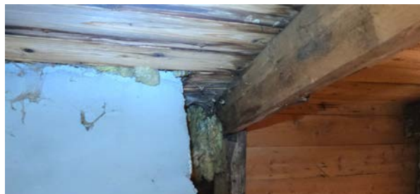
Fukt merker og svarte sopp i under tak og sperrer.
