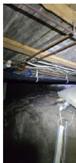
Kondensering på rør og lav høyde/begrenset tilgang.
