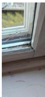
Svartsopp og kondens på innvendig vindus rammer.
