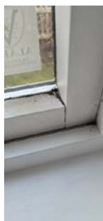
Svartsopp og kondens på innvendig vindus rammer.
