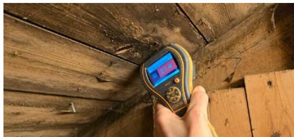
Høy fukt nivå på under tak
