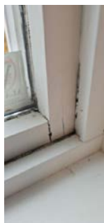
Svartsopp og kondens på innvendig vindus rammer.
