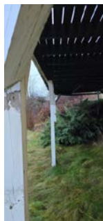
Fukt opp trekk fra terreng i stopler.
