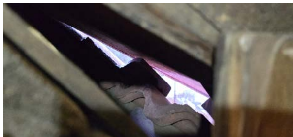
Synlig manglede beslag og utett mellom vegg og tak fra loft, vann innriv.
