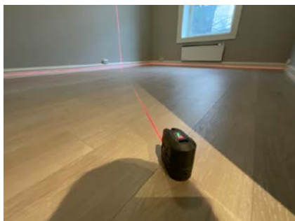
Nivellering soverom, avvik ca. 15-30 mm
