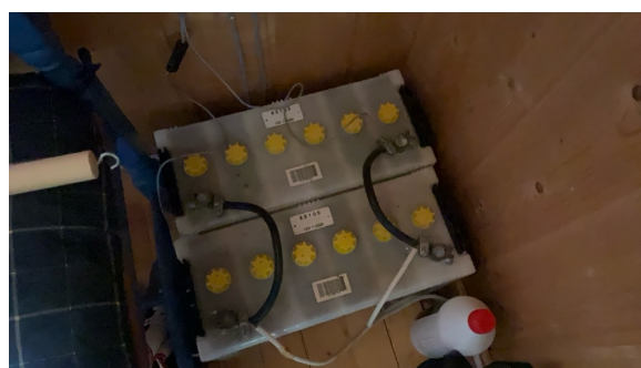
Batteribank på soverom.
