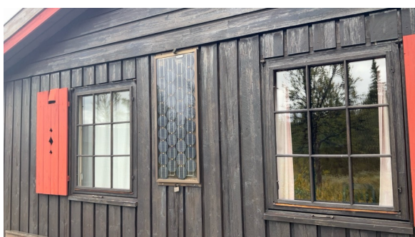
Solcelle på yttervegg.
