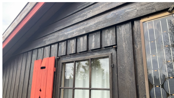
Det er ikke montert vannbrett over vinduer.
