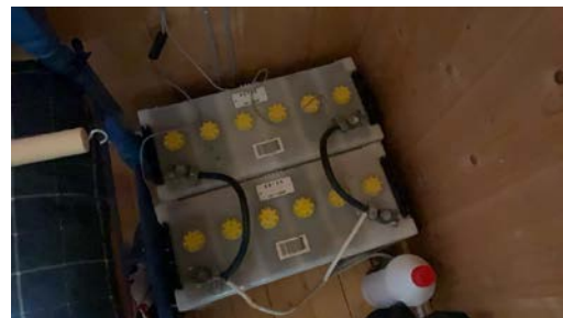
Batteribank på soverom.
