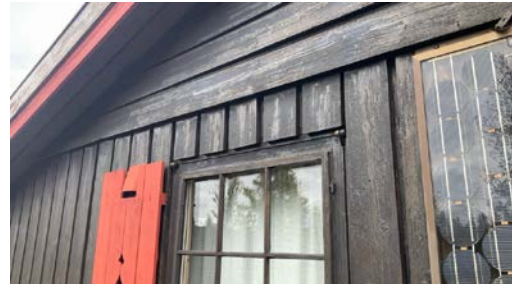
Det er ikke montert vannbrett over vinduer.
