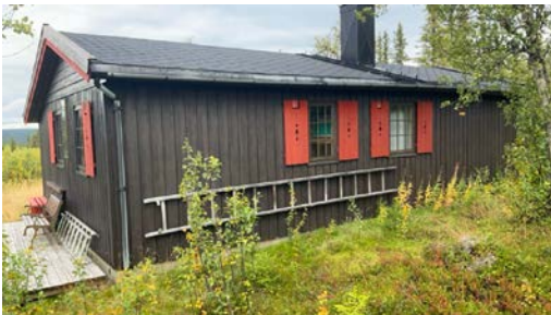
Stedvis fall på terreng mot bygning.
