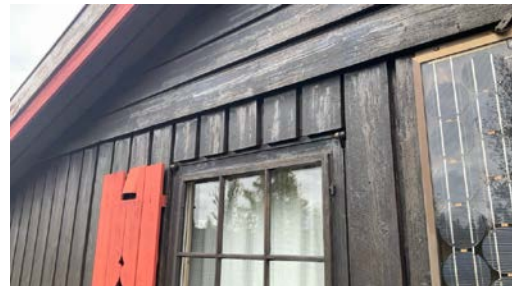
Det er ikke montert vannbrett over vinduer.
