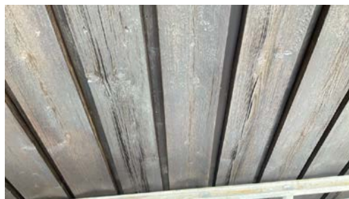
Kledning bærer stedvis preg av elde og slitasje. Sprekker på kledning er registrert.
