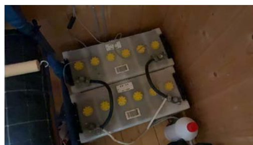
Batteribank på soverom.
