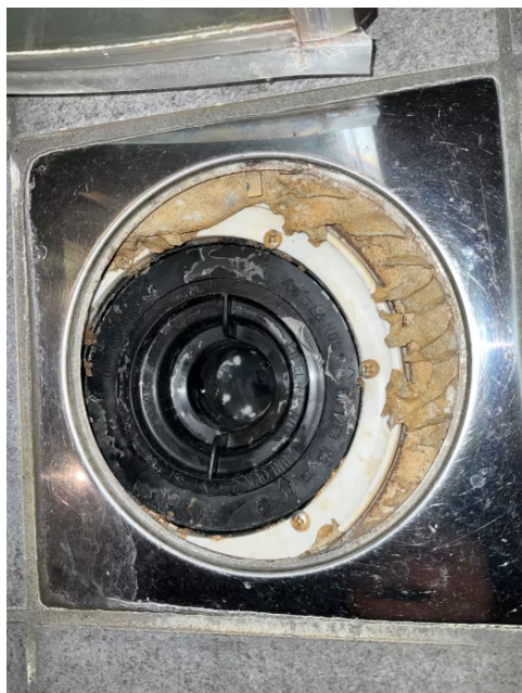
Viser sluk i dusjsone.
