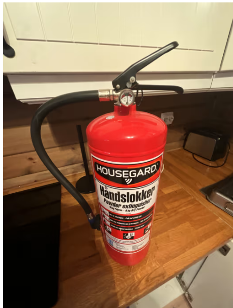
Viser brannslukningsapparat plassert i kjøkkenbenk. (Eldre enn 10 år)
