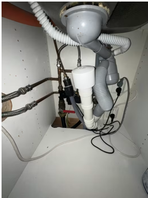
Viser vann og avløpsinnstallasjoner under kum.
