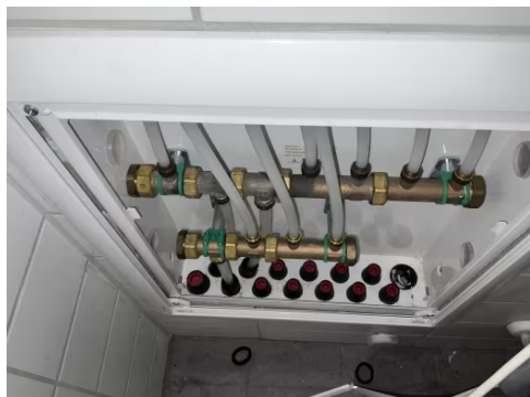
Vannrør med rør i rør system fra fordelerskap plassert på bad og frem til sanitærinstallasjoner på baderom, toalettrom og kjøkken.
