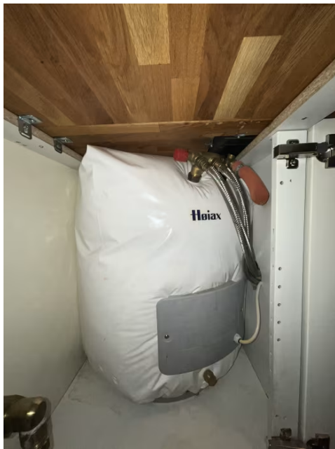
Viser bereder plassert i kjøkkenbenk.
