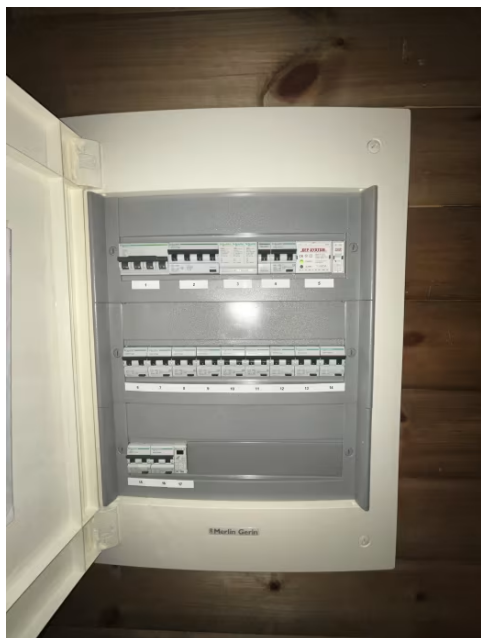
Viser sikringskap plassert i gang.
