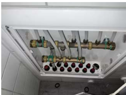
Vannrør med rør i rør system fra fordelerskap plassert på bad og frem til sanitærinstallasjoner på baderom, toalettrom og kjøkken.
