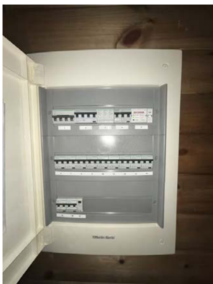
Viser sikringsskap plassert i gang.
