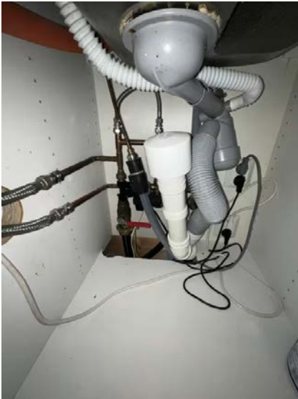
Viser vann og avløpsinnstallasjoner under kum.
