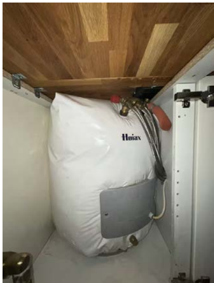
Viser bereder plassert i kjøkkenbenk.
