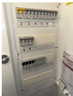
Sikringsskap med automatsikringer.
