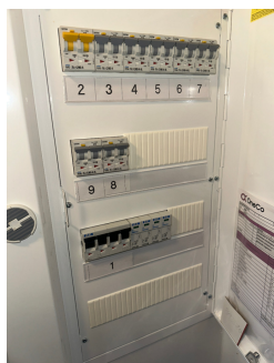
Sikringsskap med automatsikringer.
