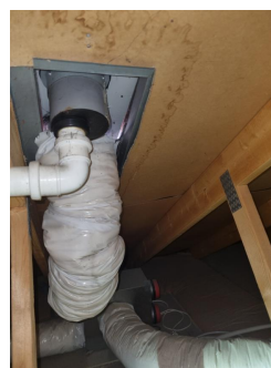
Synlige fuktskjolder rundt luftehatt og rundt pipe. Ingen fuktavvik på befaringsdagen
