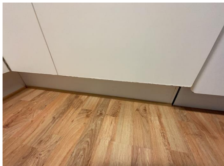
Slitasje på nedre del av dør under vask
