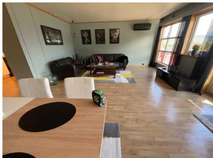
1. etasje Plassering av laser ved kontroll av stue. Det er målt 8 mm høydeforskjell gjennom rommet. TG 1
