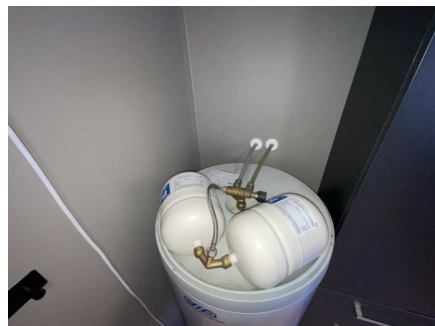
Ekspansjonskar er integrert på toppen av varmtvannsbereider
