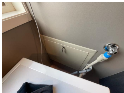
Fordelerskap. Anbefaler å merke dør med hovedstoppekrane
