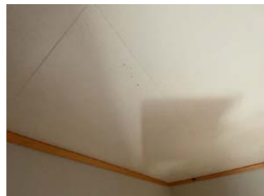
- Avskalling i overflate på deler av himlingsplater i leiligheten.
