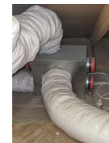
Sentralavtrekk er plassert på kryploft
