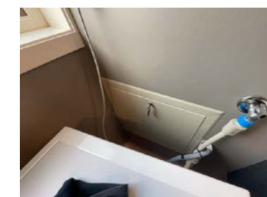
Fordelerskap. Anbefaler å merke dør med hovedstoppekrane
