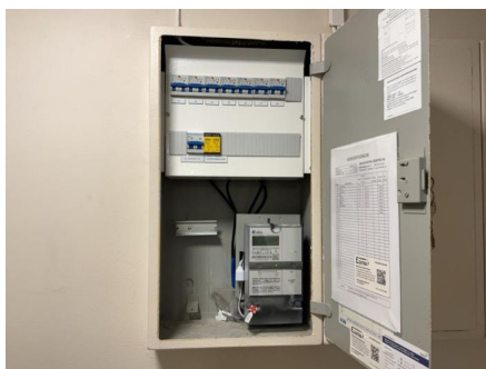
Sikringsskap plassert i felles oppgang.
