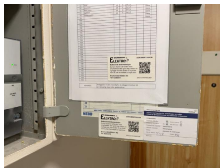
Dokumentasjon via QR kode i sikringsskap.
