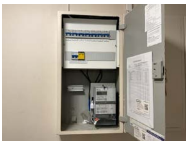
Sikringsskap plassert i felles oppgang.
