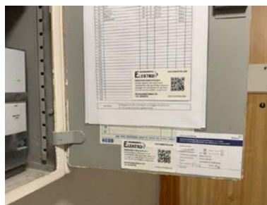
Dokumentasjon via QR kode i sikringsskap.
