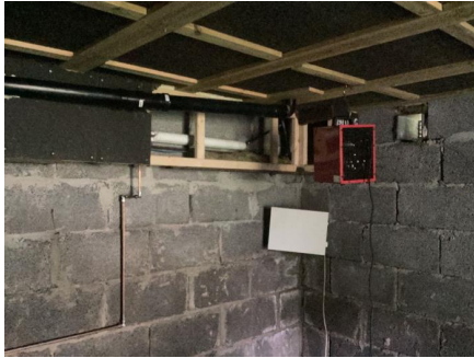
Vannrør under bad må tilsynelatende følges med på på vinterstid.
