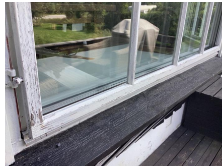
Eksempel på utvendig slitasje.
