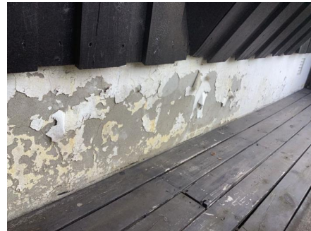
Eksempel på avskaling av maling.
