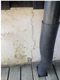
Eksempel på sprekk i grunnmur.
