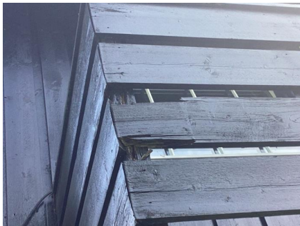
Råteskade på rekkverk på balkong.
