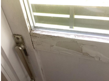
Eksempel på innvendig slitasje på verandadør.
