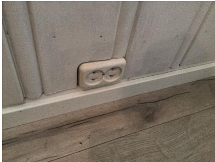
Stikkontakt for åpent anlegg ligger innfelt i brystningspanel.
