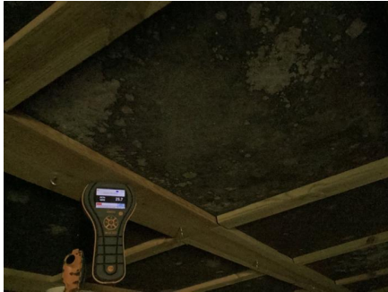
Høyt fuktinnhold i treverk i kjelleren.
