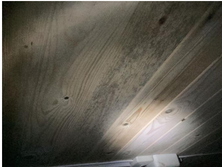
Muggsopp på trepanel i himling.
