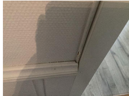
Kabel går inn bak brystningspanel.
