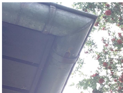
Utetthet i takrenne i rustpunkt under takrenne.
