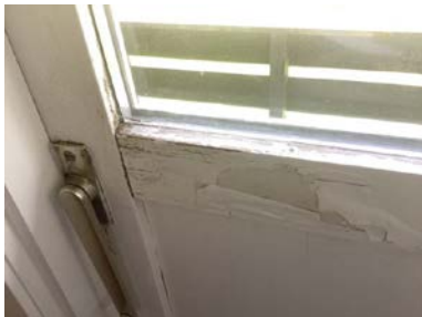
Eksempel på innvendig slitasje på verandadør.
