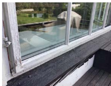
Eksempel på utvendig slitasje.
