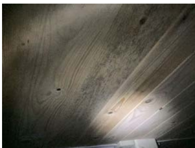
Muggsopp på trepanel i himling.
