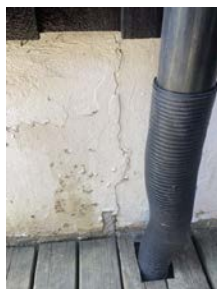
Eksempel på sprekke i grunnmur.
