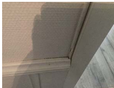
Kabel går inn bak brystningspanel.
