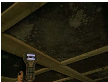
Høyt fuktinnhold i treverk i kjelleren.
