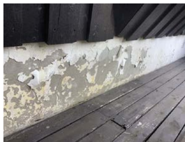
Eksempel på avskaling av maling.
