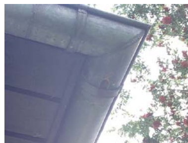
Utetthet i takrenne i rustpunkt under takrenne.
