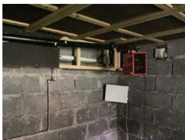
Vannrør under bad må tilsynelatende følges med på vinterstid.
