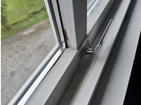
Det registreres tegn til kondens på innsiden av vinduer (krakelert maling).
