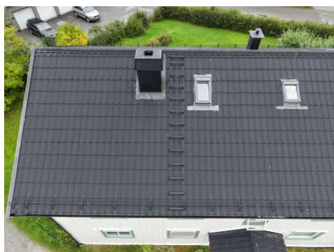
Det er etablert takstige og snøfanger på taket.
