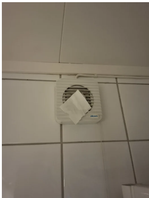
Avtrekkseffekt er testet med papir.
