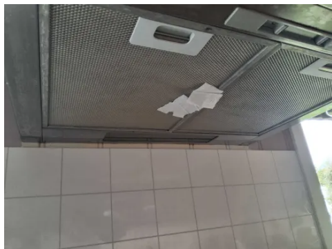
Avtrekkseffekt er testet med papir.
