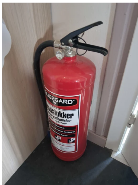
Brannslukningsapparat er plassert i entré.
