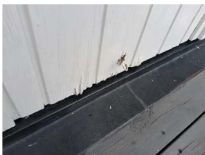
Det registreres svelleskader på balkongdøren.
