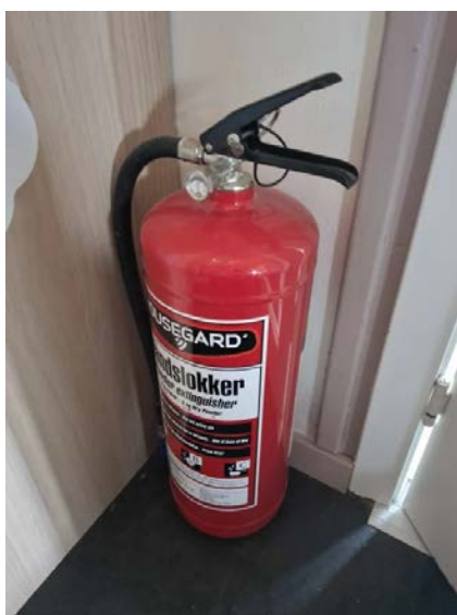
Brannslukningsapparat er plassert i entré.
