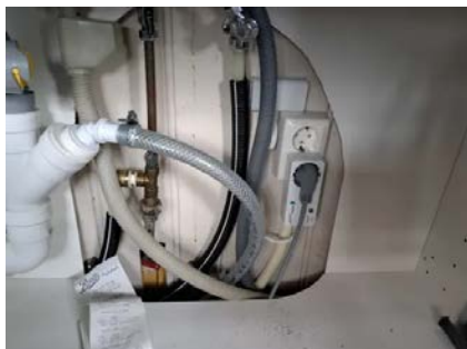
Leiligheten har vannrør av rør-i-rør og kobber.
