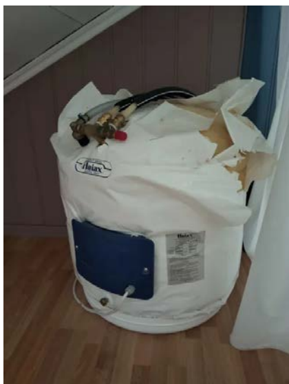
Varmtvannsbereder er koblet med plastrør.
