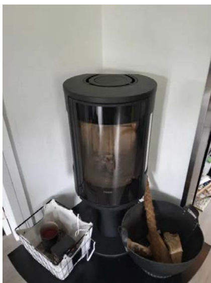
Vedovn med glassdør i stue.
