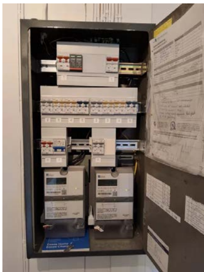
Felles sikringsskap med automatsikringer i trappegang.
