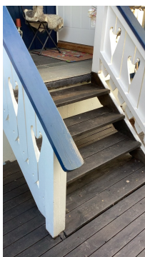
Rekkevrk har ikke dagens krav til høyde
