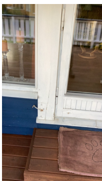
Terrassedør i 1 etg bærer preg av alder og trenger vedlikehold
