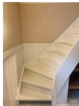
Trappen mangler rekkverk i sin helhet
