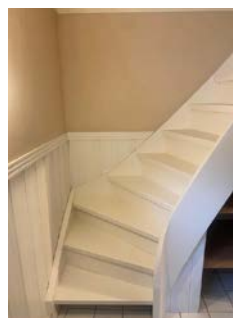
Trappen mangler rekkverk i sin helhet
