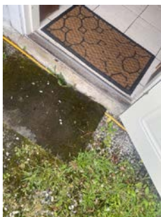
Dør i underetg må utbedres med beslag og bedre tetting under dør
