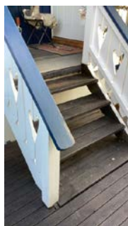
Rekkevrk har ikke dagens krav til høyde
