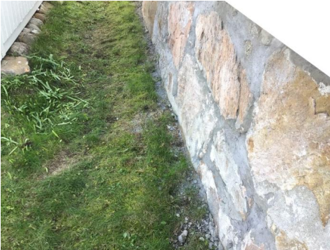
Mangler fuktsikring langs grunnmur
