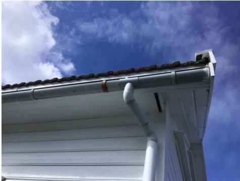
Enkelte kroker til takrenne med rust
