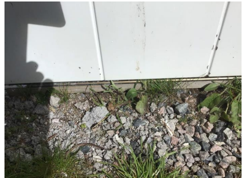
Mangler beslag under kjellerdør
