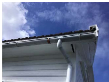
Enkelte kroker til takrenne med rust
