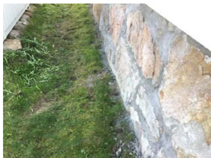
Mangler fuktsikring langs grunnmur
