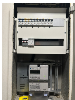
Sikringsskap med automatsikringer.
