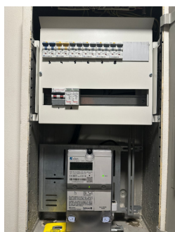
Sikringsskap med automatsikringer.
