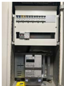
Sikringsskap med automatsikringer.
