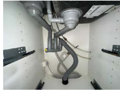
Rørøpplagg i kjøkkenbenk
