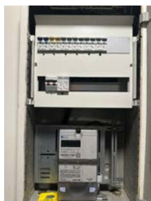
Sikringsskap med automatsikringer.
