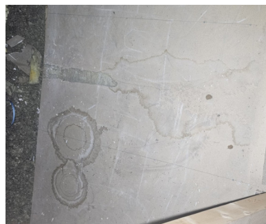
Kondensmerker på gulv under uisolert ventilasjonskanal.
