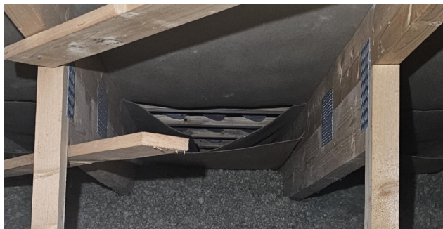
Enkelte sutakplater på nedre del av takflate har løsnet.
