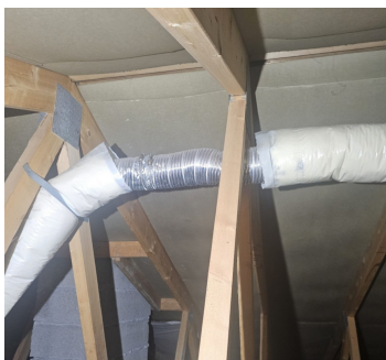
Uisolert ventilasjonskanal på loft.
