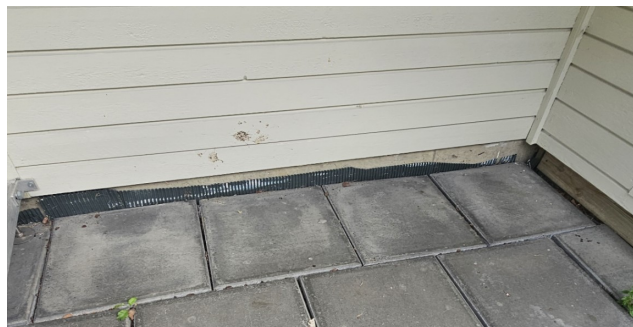
Knotteplast/grunnmursplate mangler klemlist.
