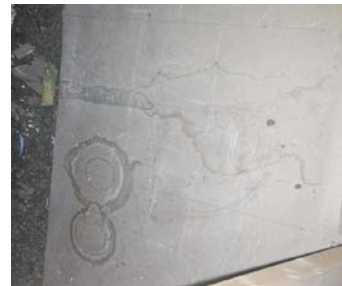
Kondensmerker på gulv under uisolert ventilasjonskanal.
