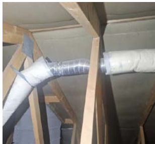
Uisolert ventilasjonskanal på loft.
