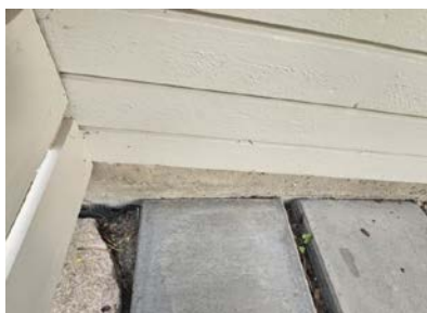
Kun delvis synlig fuktsikring (knotteplast/grunnmursplate) som er uten klemlist og som delvis er avsluttet under terreng.
