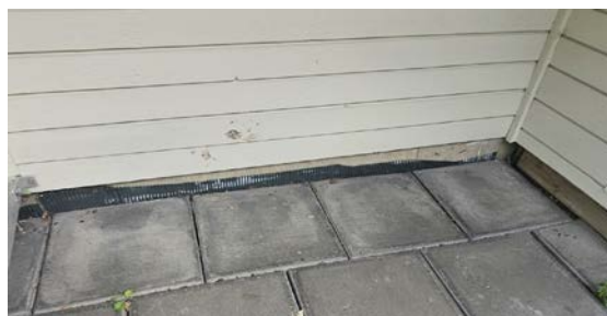
Knotteplast/grunnmursplate mangler klemlist.
