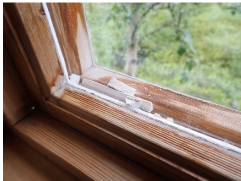
Slitasje og løsnet kitt.
