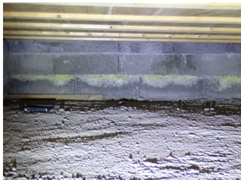
Saltutslag i mur.
