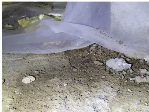
Synlig vann ved tank til biodo.
