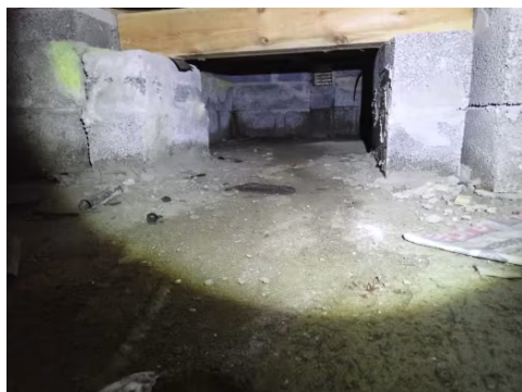
Tydelig innsig gjennom grunnmur.
