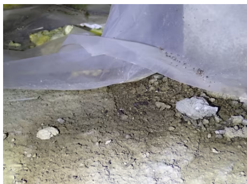
Synlig vann i krypkjeller. Dette er ved tanken til biodoen.
