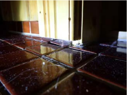
Synlig at det kan mangle, eller er dårlig utførelse av membran.
