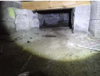
Tydelig innsig gjennom grunnmur.
