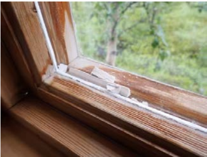
Slitasje og løsnet kitt.
