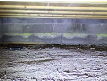
Saltutslag i murer.
