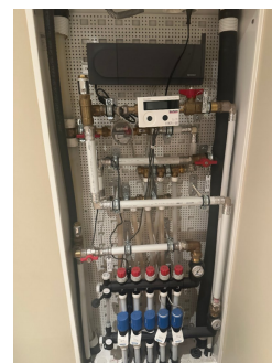
Samleskap med rørkurser og stoppekraner
