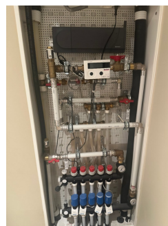
Samleskap med rørkurser og stoppekraner
