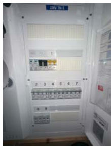
Sikringsskap med automatsikringer.
