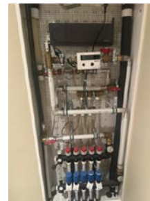
Samleskap med rørkurser og stoppekraner
