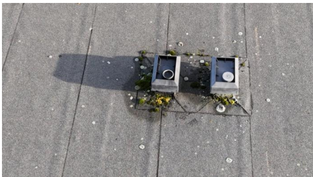
Noe mose ved luftehatter over tak.
