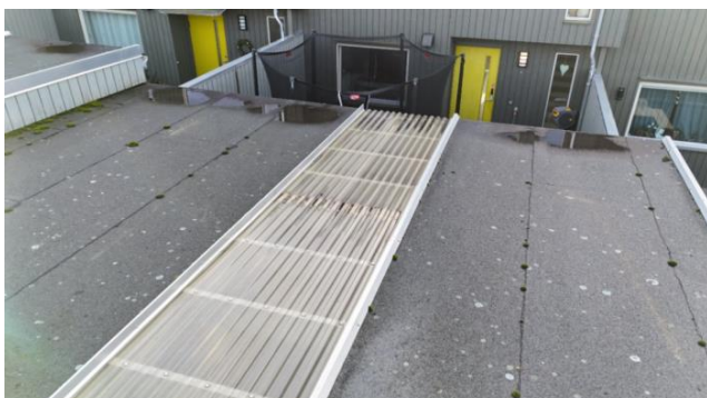
Noe mose og gjenstående vann på papptecking over bod og carport.
