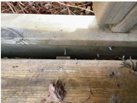
Svak innfestning av konstruksjonen.
