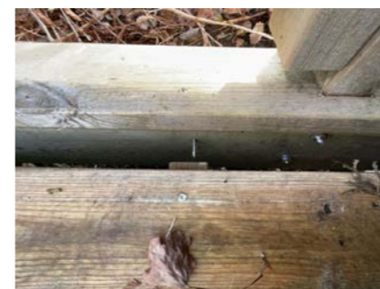
Svak innfestning av konstruksjonen.
