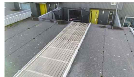
Noe mose og gjenstående vann på papptekking over bod og carport.
