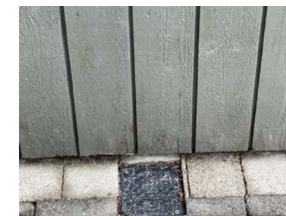
Nedre del av kledning under soveromsvindu.
